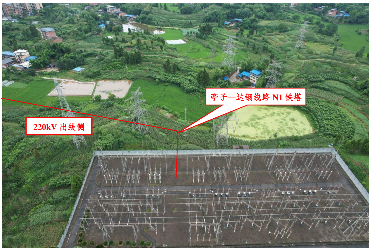
亭子 220kV 变电站出线方向
